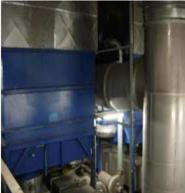
Oxidación Térmica Rotativa RTO
