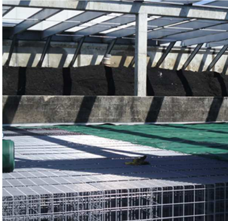
Suelo técnico del biofiltro
