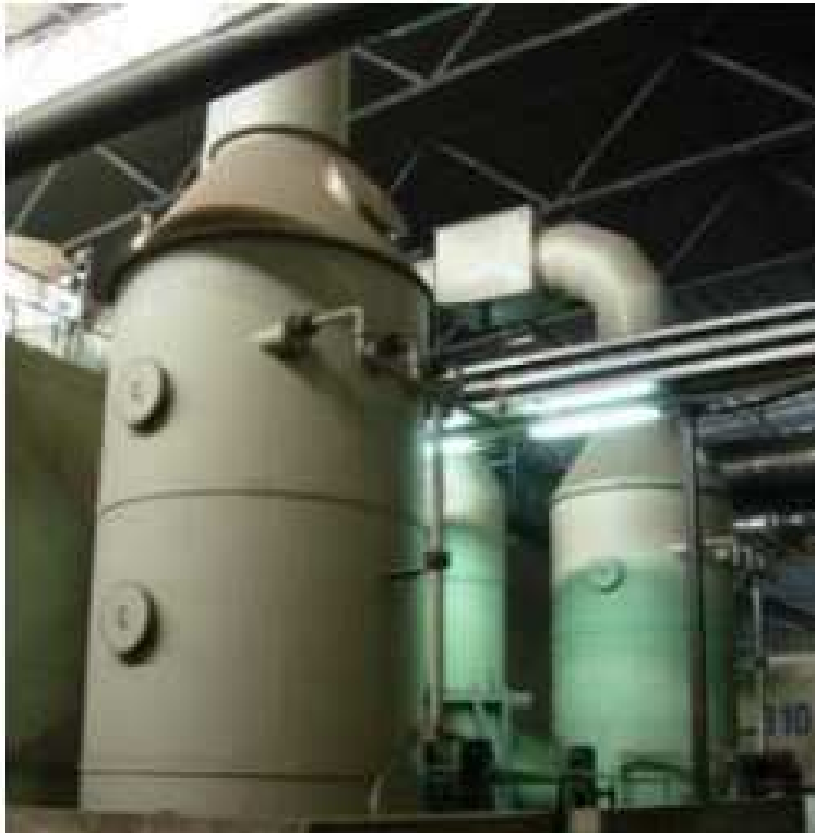
Lavadores de gases verticales Torres TLVA-270/2 en PP de Plastoquímica
